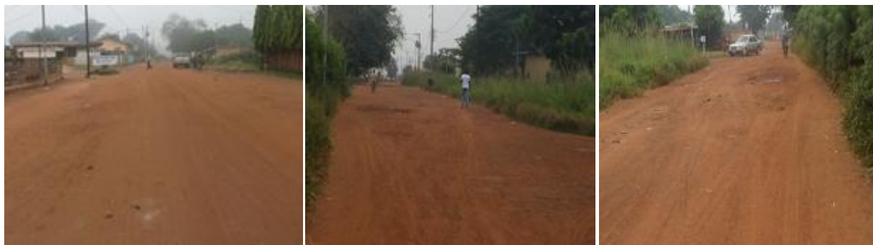
Aperçu de l'état de dégradation de la voie Photos : TERRABO, novembre 2014
