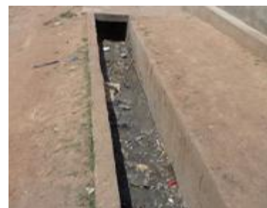
Vue d'un caniveau obstrué Photos : TERRABO, novembre 2014
