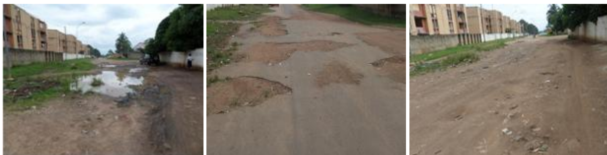
Aperçu de l'état de dégradation de la voie Photos : TERRABO, novembre 2014
