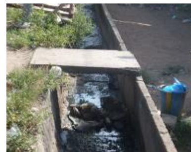
Aperçu d'un caniveau obstrué Photo : TERRABO, novembre 2014
