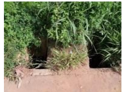
Ouvrage de drainage obstrué Photo : TERRABO, novembre 2014
