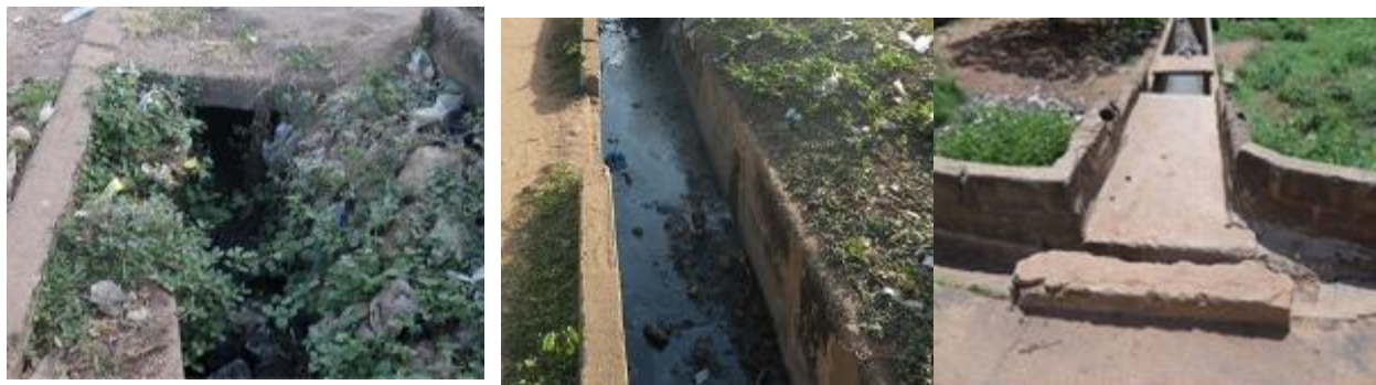
Vue de l'état de dégradation des ouvrages de drainage Photos : TERRABO, novembre 2014
