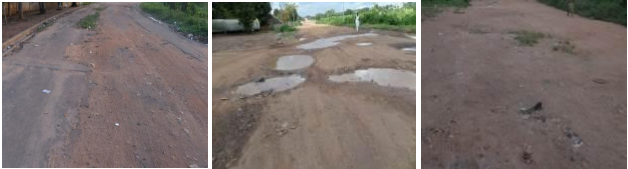
Aperçu de l'état de dégradation de la voie Photos : TERRABO, novembre 2014
