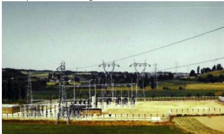
Figure 4. Exemple d’un poste 225/90 kV (©RTE)
