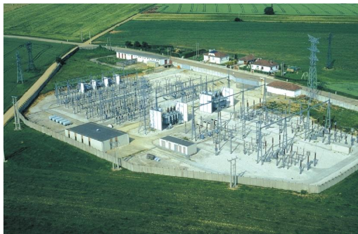
Figure 5. Vue aérienne d’un poste 225/90 kV (©RTE)
