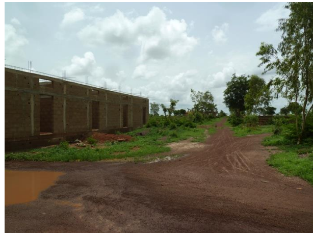
Habitation en construction le long de la piste de Kakabougou. (@X. MONBAILLU)
