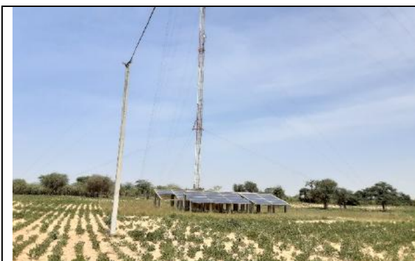
Presence d'une antenne, P.solaire et potence
