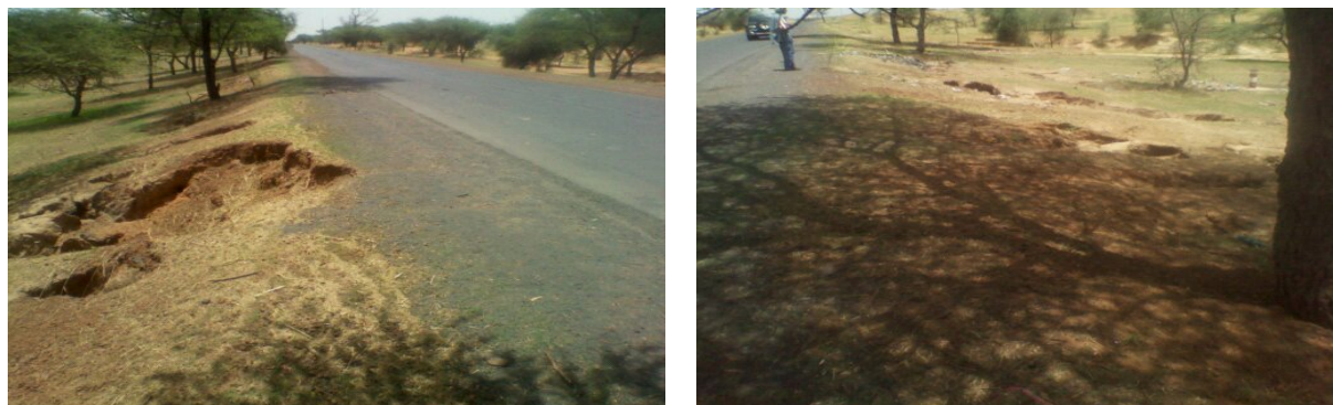
Photo 6: Erosion et ravinements aux abords des remblais par manque d'ouvrage sur l'axe Louga - Dahra (R31/D309)
