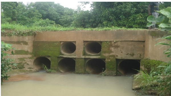
Photos 18 : PK 12+860 6 buses Ø800 à démolir et remplacer par un nouvel ouvrage à dimensionner
