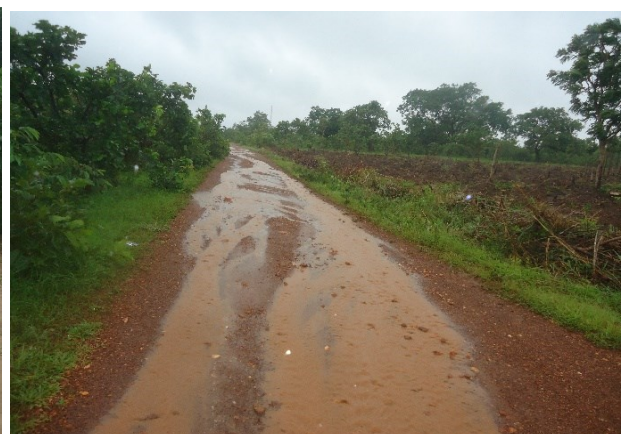
Photos 13 : PK 6+500 – eaux de ruissellement sur la route existante par manque de fossés
