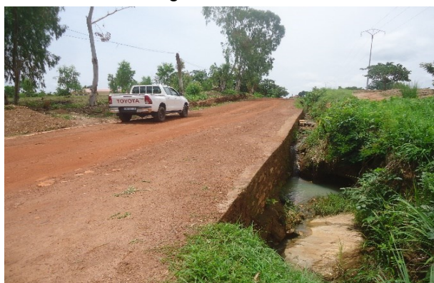
Photos 17 : PK 14+400 ravinement longitudinal
