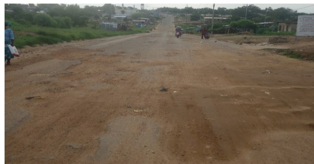
Photos 21 : PK 29+550 – traversée urbaine de Kara présentant un revêtement en enduit superficiel bicouche très dégradée.
