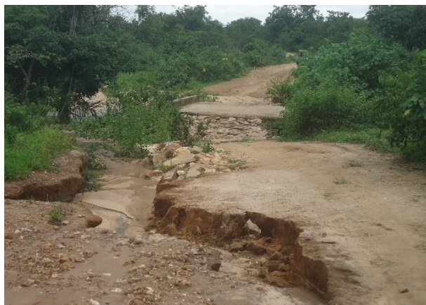
Photos 12 : PK 3+350 – ravinement longitudinal
