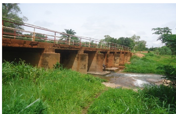
Photos 15 : PK 7+280-7 pont dalle à 10 travées de 3 m à démolir et remplacer par un nouvel ouvrage à dimensionner
