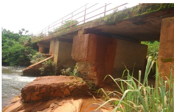
Photos 14 : PK 3+500 – pont dalle à 5 travées de 5 m sur la rivière Sara à démolir et remplacer par de nouvel ouvrage à dimensionner
