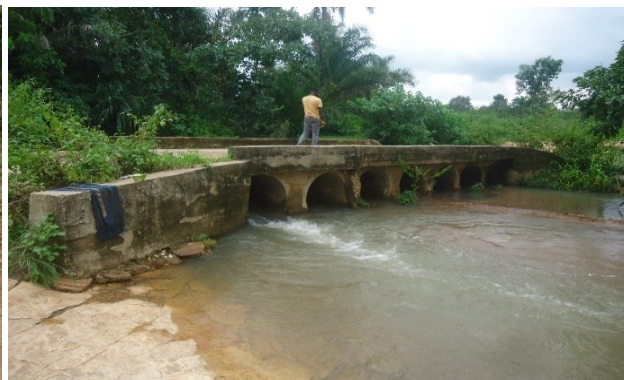
Photos 11 : PK 3+130 – 7 buses Ø800 existants à démolir et remplacer par un nouvel ouvrage à dimensionner
