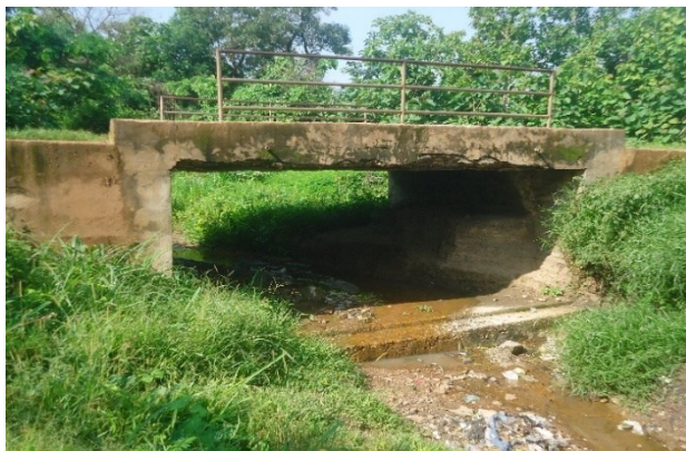
Photos 26 : PK 9+920 – pont cadre 1x5,00x2,00 vétuste à démolir et remplacer par un nouvel ouvrage à dimensionner
