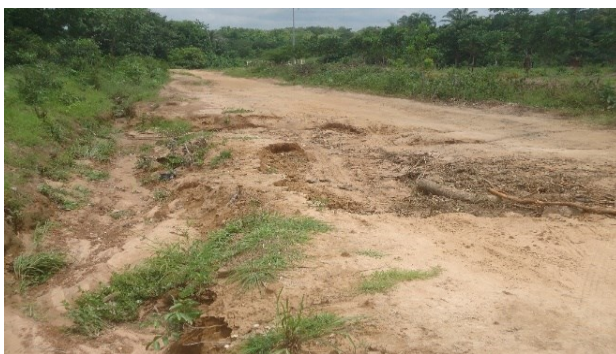
Photos 8 : PK 20+700 – aperçu sur une zone de dégradation
