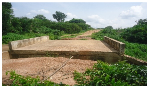
Photos 9 : PK 28+350 – dalot 2x3,00x2,00 effondré
