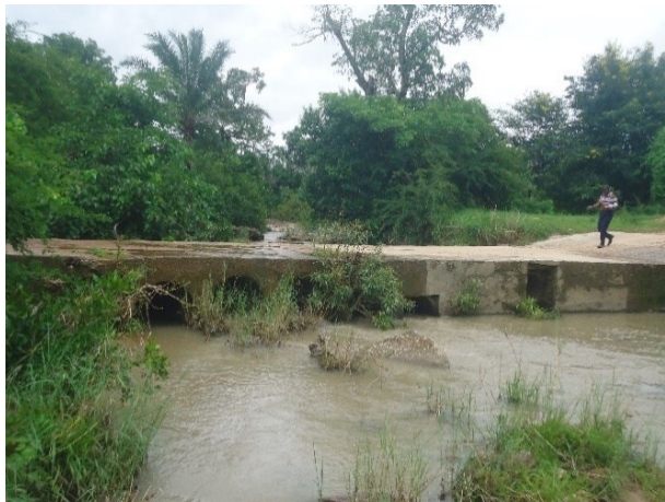
Photos 24 : PK 5+740 – Radier busé à démolir et remplacer par un nouvel ouvrage à dimensionner
