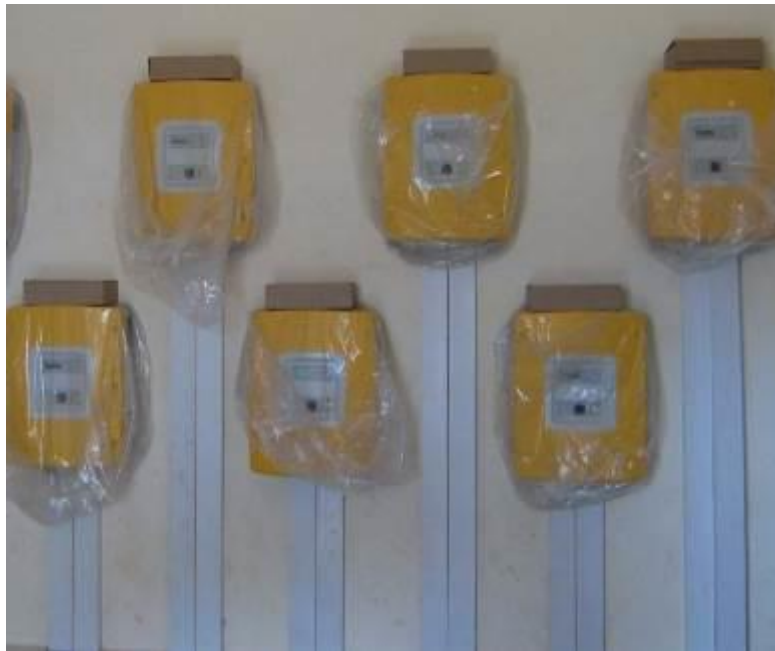
Photo 2 : Exemple d'onduleurs photovoltaïques Sunny Island 48V_{CC}/230V_{CA}
