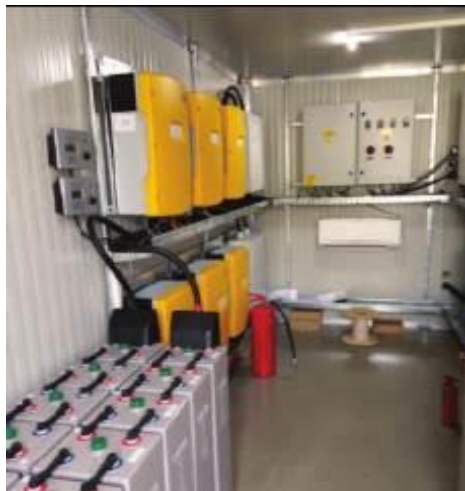
Photo 6 : Exemple de local technique containerisé
