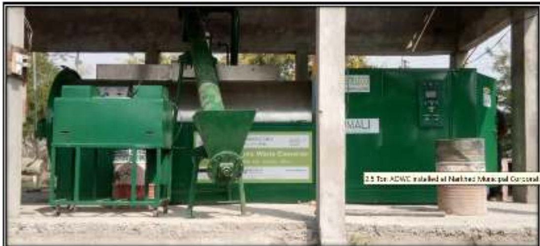
Figure 1 : Fermenteur à environnement modifié adopté pour la valorisation des déchets municipaux dans les villes de Sawantwadi et de Narkhed en Inde (2,5 tonnes par jour)
