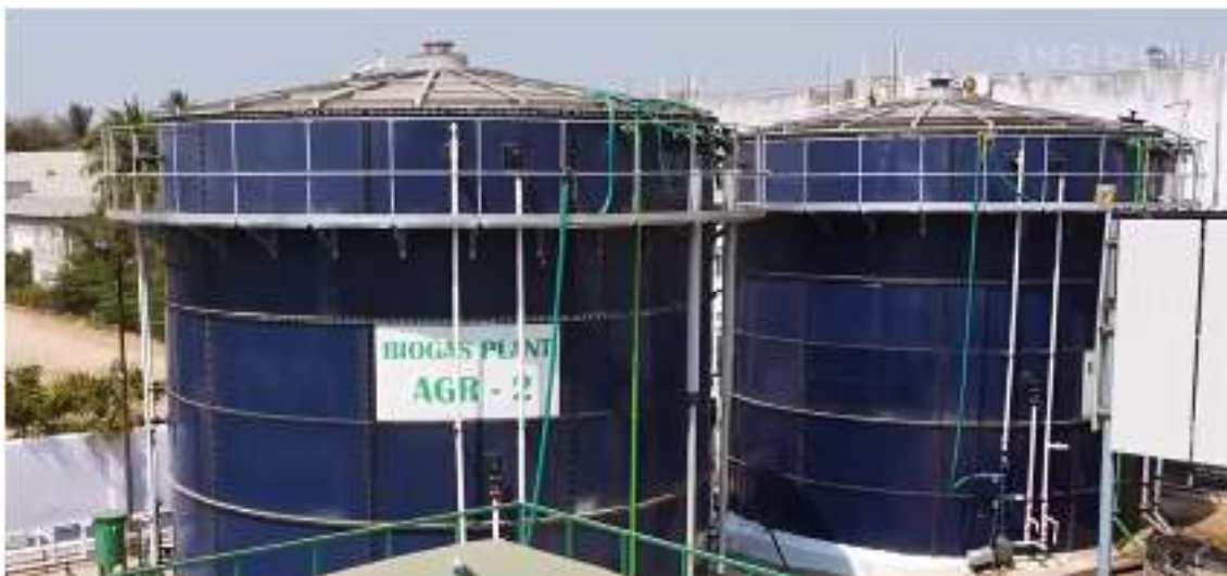
Figure 4: Digesteurs utilisés pour la production du biogaz à partir des déchets du marché aux légumes de Bowenpally
