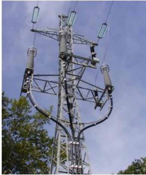
Source : Figure 20 : Pylône type aéro-souterrain
