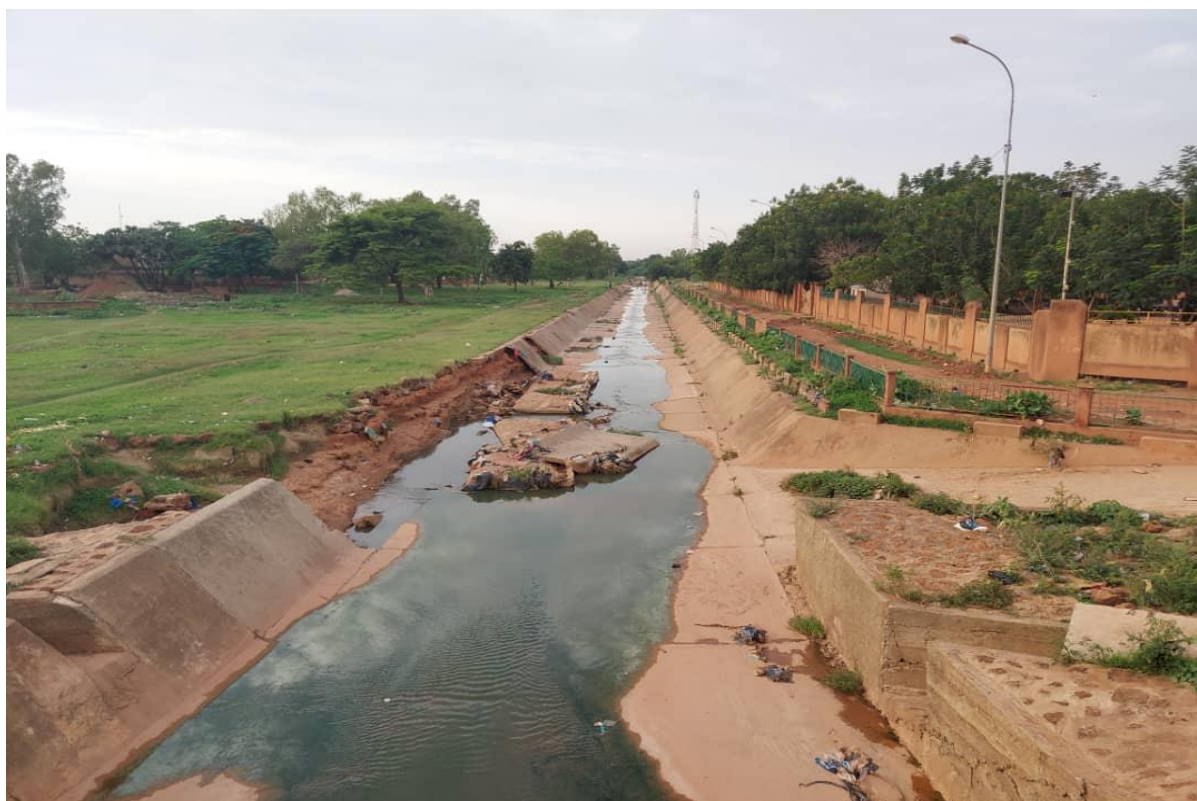
Photo 6: Etat des infrastructures en aval du site
